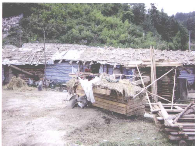
林桥村遭山体滑坡后，村民现居住的房子
