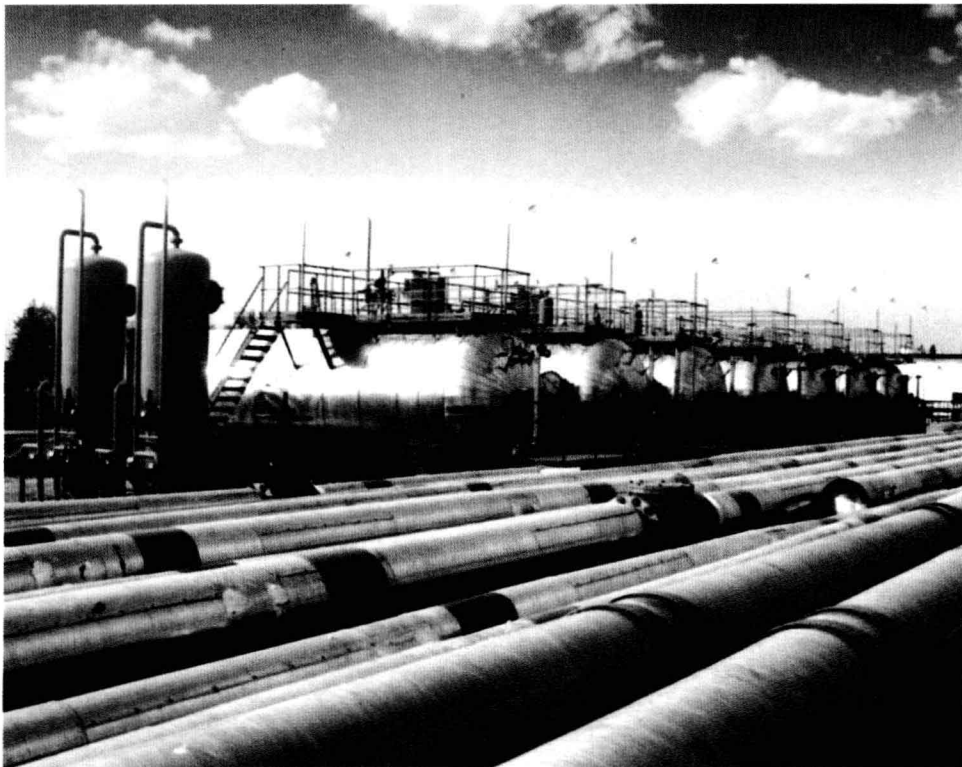
中国石化股份公司五星级联合站——王场联合站
