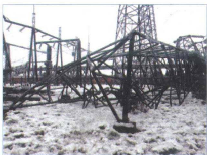
2008年冰灾 • 冰雪损坏变电站5座。
