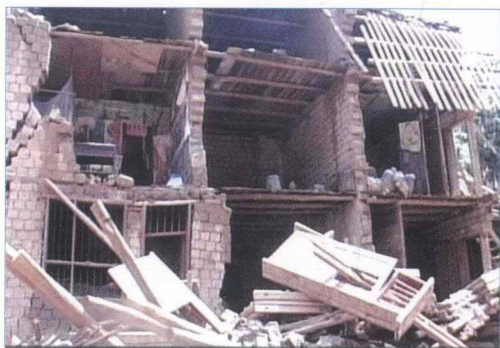
2006年“7·15”洪灾·洪水损坏的房屋。
