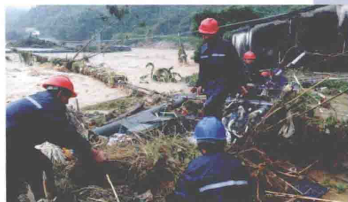
2013年8月16日，台风“尤特”致汕尾地区突降暴雨。图为供电员工正在海丰西坑紧张抢修被洪水冲垮的变压器。
