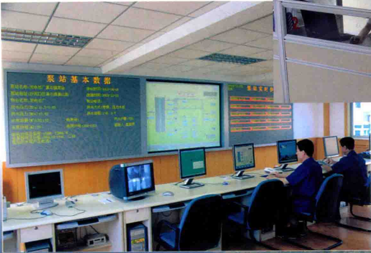
二次加压泵站无人职守调度中心
