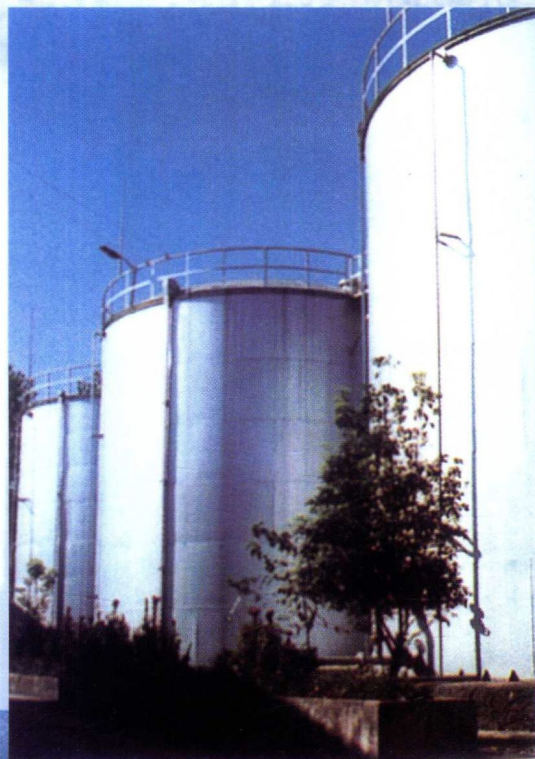
储油 500 吨的油罐
