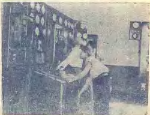
電氣股配電室做到了漲落負荷制 ，與鍋爐股聯絡後調整過渡電壓。併 車時間由八分鐘縮到三分鐘，減少了 熱量的消耗。
