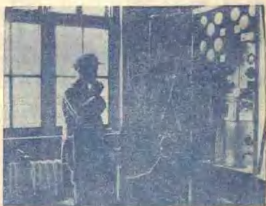
電力調度得當。圖爲配電室利用七〇〇瓩電壓，經鐵路，隨時使京津唐三處通話聯絡，而能適當的分配電力。
