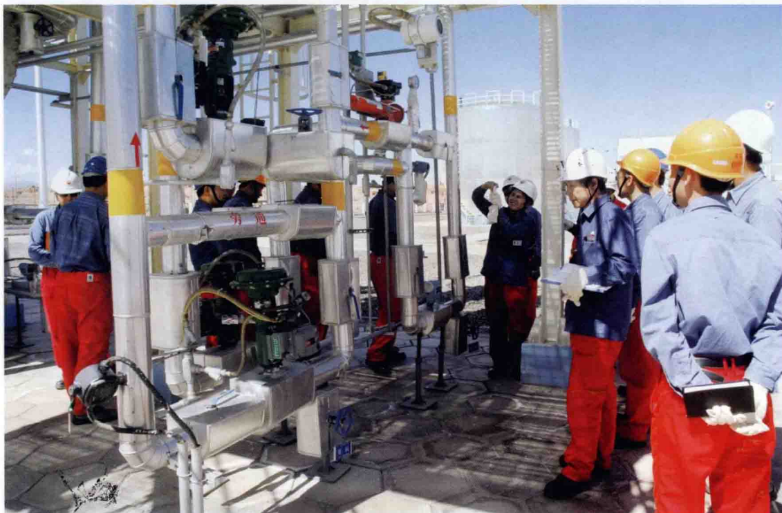
克拉 2 气田中央处理站巡检（熊斌摄）
