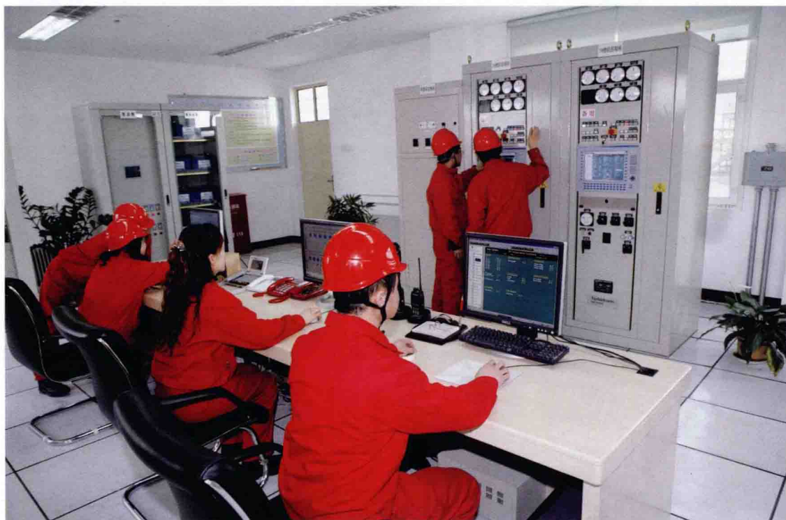
克拉作业区员工在监控燃气机组运行状态
