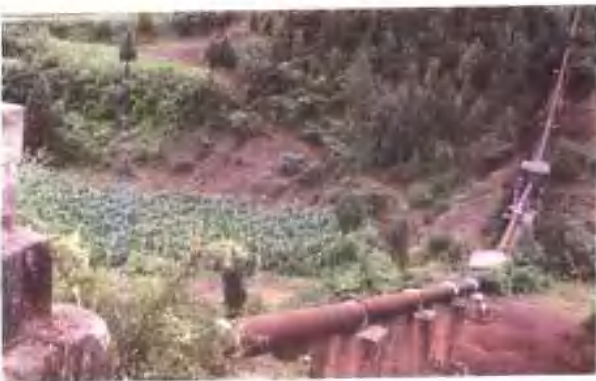
白埡子支渠倒虹管
