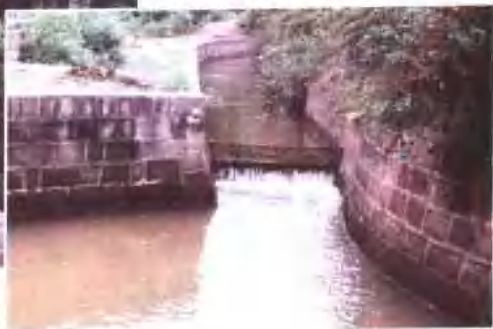
青树埡电站前池
