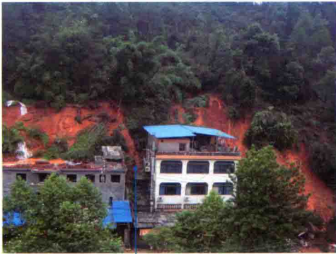
山边滑坡影响房屋建筑安全
