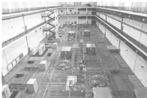
图 0-10 南水北调干渠某泵站
