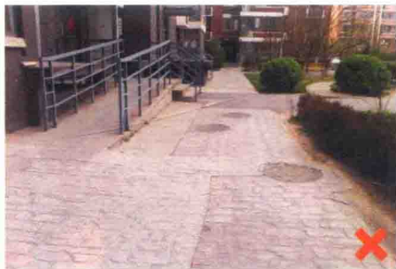
地面铺装材料凹凸不平
