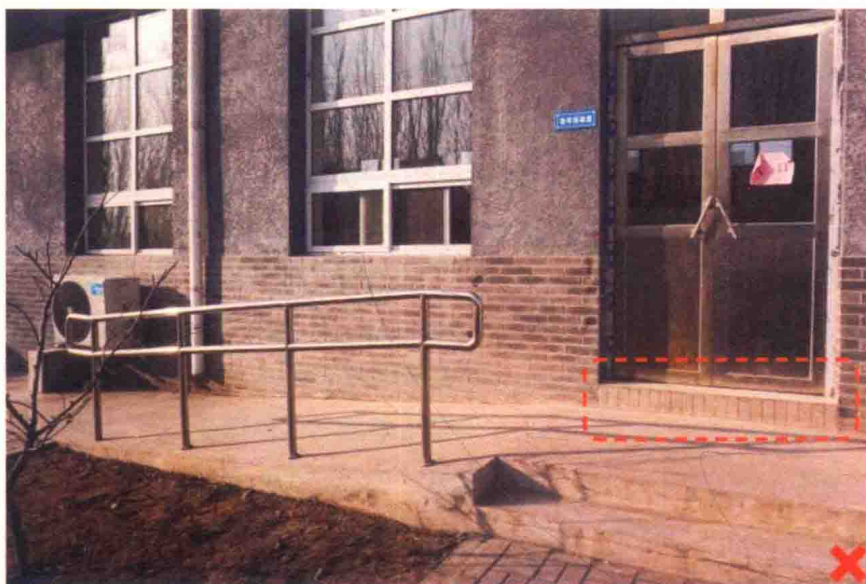
图 1-1 建筑门前虽设有坡道,但入口设置门槛,无法实现无障碍通行
