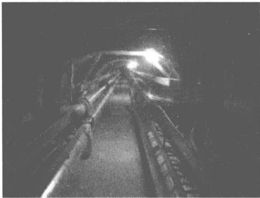
图 1-11 德国综合管廊（1）
