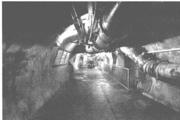
图 1-4 巴黎综合管廊（2） ( http://www.water8848.com/news/201609/22/78386.html )
