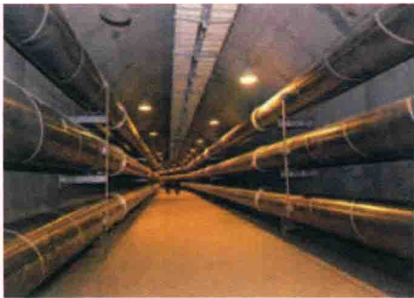
图 1-10 水平长廊及 800kV GIL
