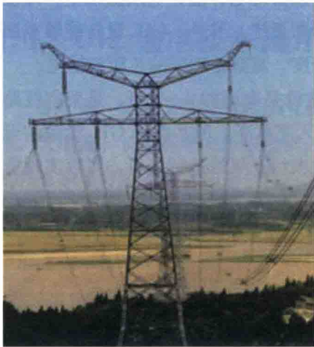
图 1-4 架空输电线路实物图
