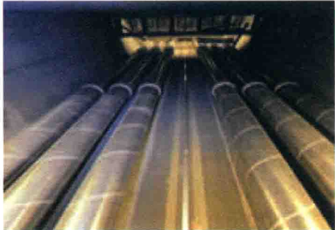
图 1-11 垂直竖井及 800kV GIL
