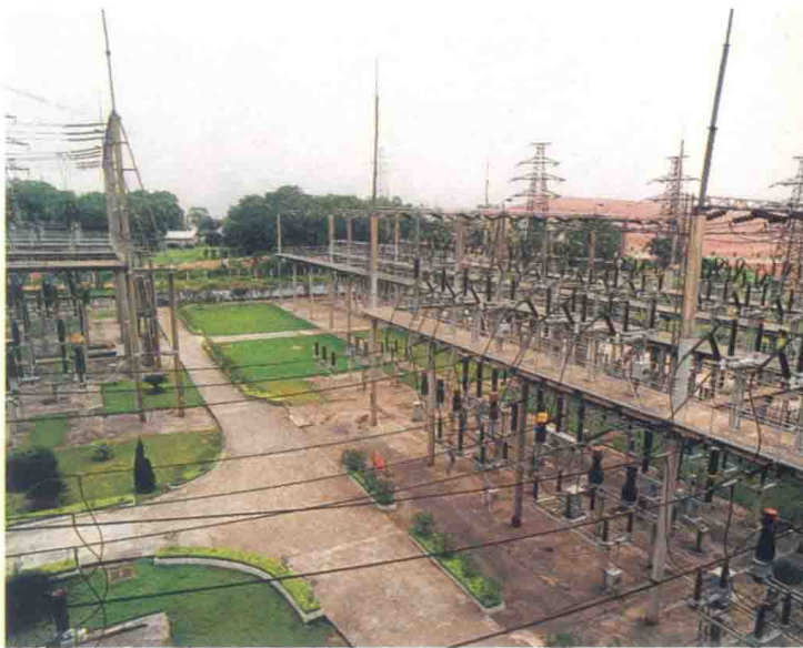
1983年，东莞市第一座220千伏板桥变电站投产
