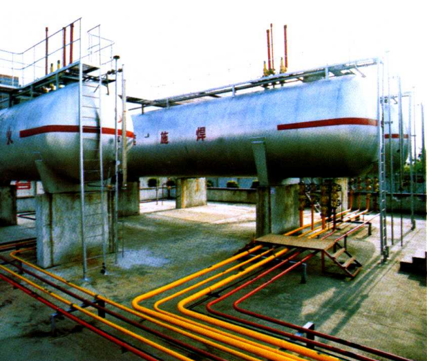
市管道液化气锦屏储配站
