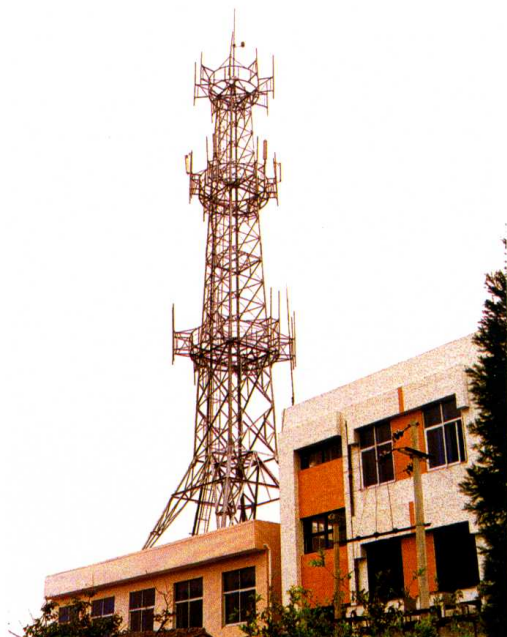
移动通信基站
