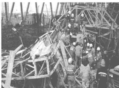
图 1-2 11·24 丰城电厂施工平台倒塌事故
