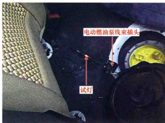
检查电动燃油泵电源电路
