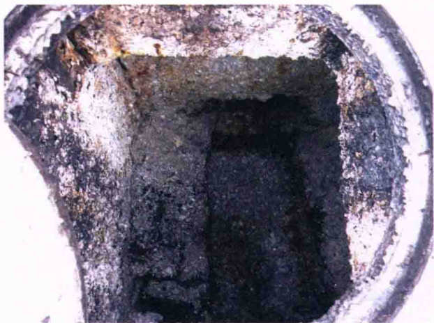
图 1.3 受生活污水腐蚀的钢筋混凝土管道
