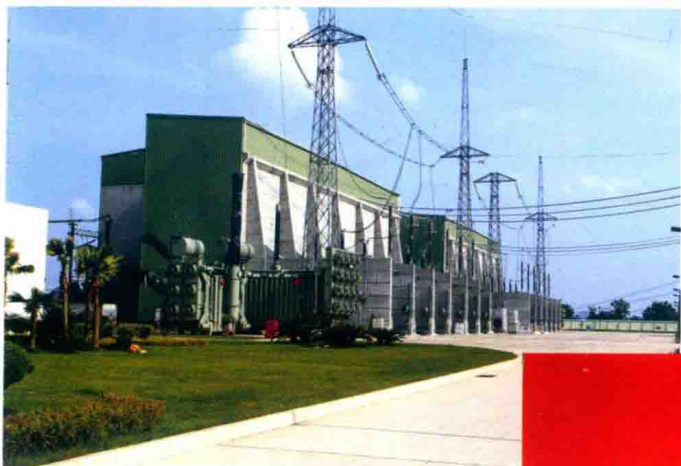
2005年建成的(正、负)500千伏安顺换流站,最大输送容量300万千瓦
