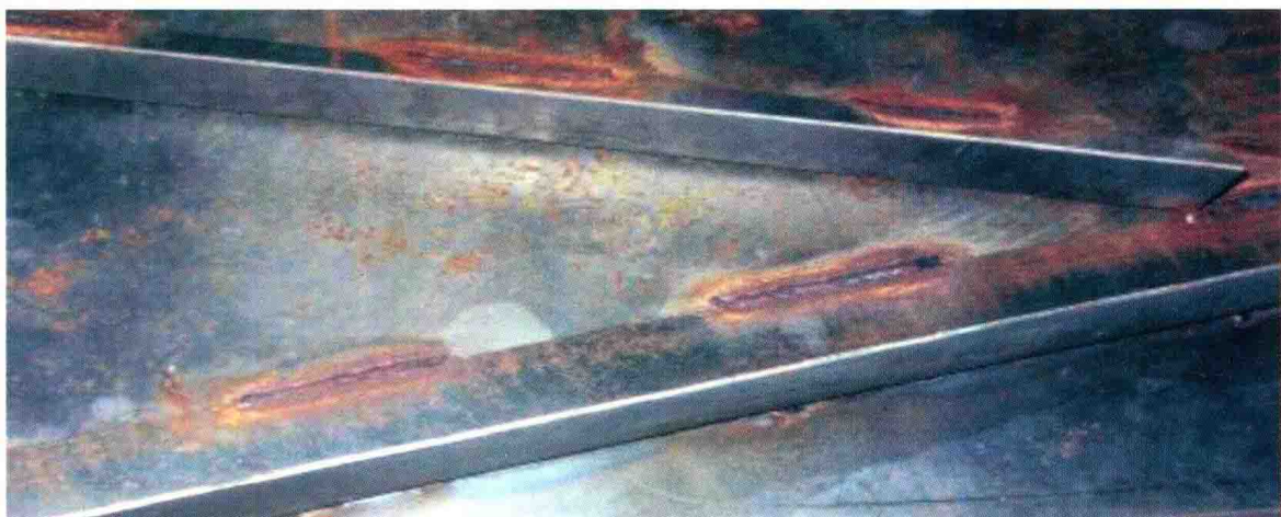
图5-15 断续焊腐蚀形貌
