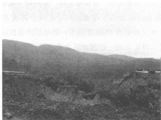
图 1-1 在雨季被雨水冲塌的西双版纳公路
