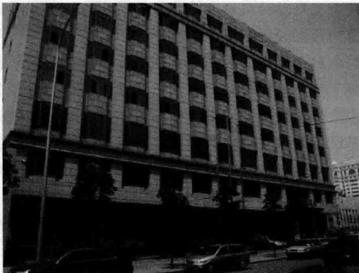
图 1-2 朝阳门 220kV 变电站
