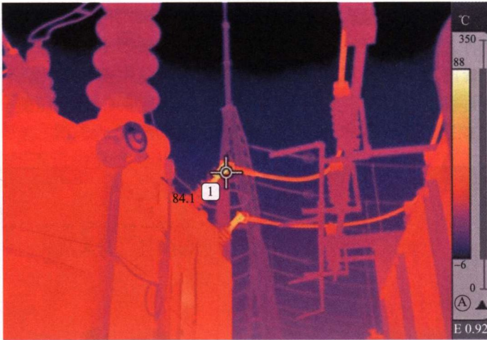
图 2 3 号主变压器 C 相低压侧套管桩头
