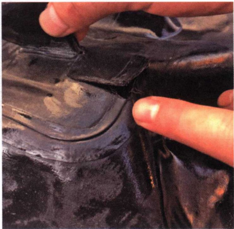
图 1 C 相储油柜胶囊破损处
