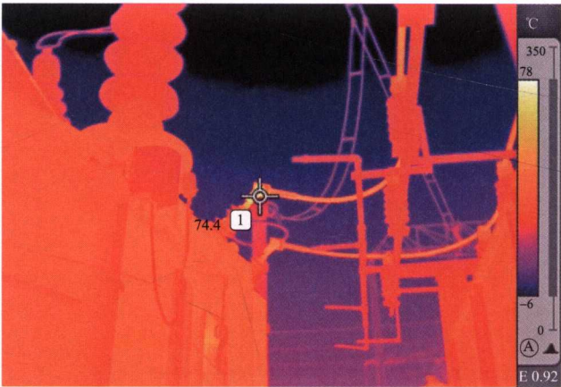
图 1 3 号主变压器低压侧 A 相套管桩头红外测温情况
