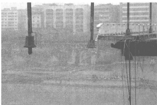
图 1-7 宜宾小南门大桥垮塌事故
