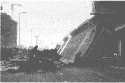
图 1-14 哈尔滨阳明滩大桥引桥垮塌事故
