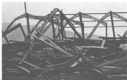
图 1.3 门式刚架结构整体失稳
