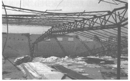
图 1.6 管桁架结构整体失稳
