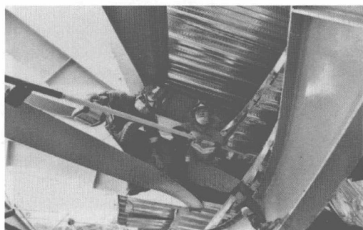
图 1.4 钢框架结构整体失稳
