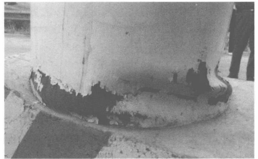
图 1.10 钢管柱脚局部失稳
