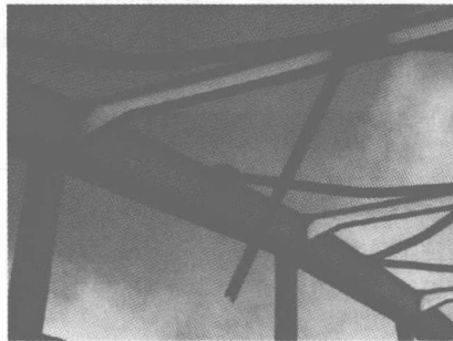
(a) 拱桥横向支撑压屈、节点板破坏
