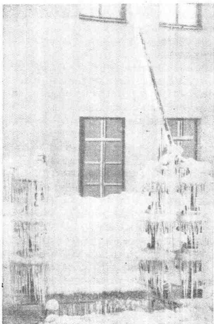
圖 2 冰冻盖满了的室外隔离开关。
