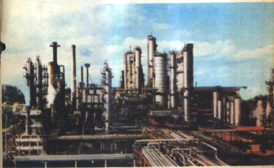
加热炉和常减压分馏塔
