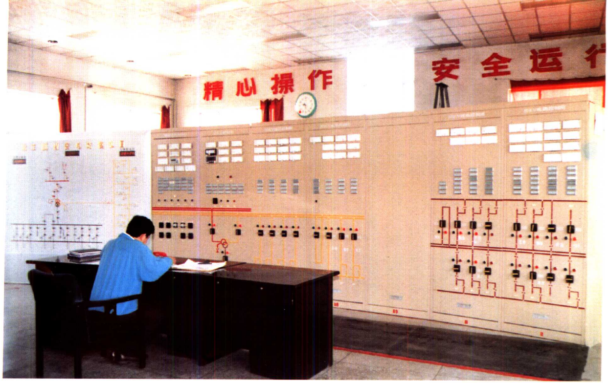
北庄变电站主控室
