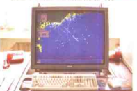
主控制台 Main control Panel
