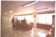
交管中心工作室 Control-room in VTS
