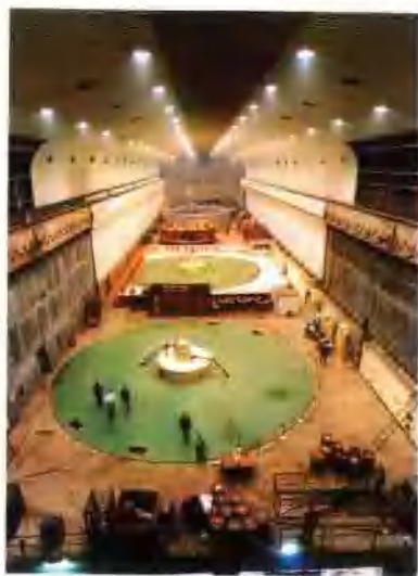
地下发电厂房（局部）
