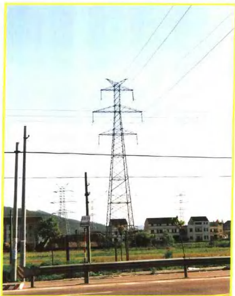
220 千伏进线铁塔
