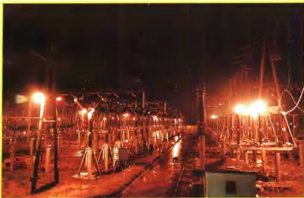
220 千伏慈溪变电所开关站夜景
