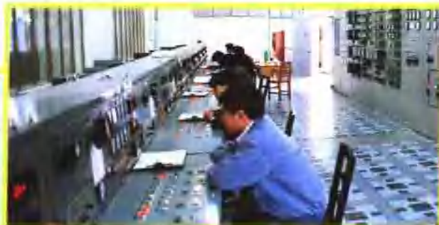
慈溪调峰电厂主控制室
