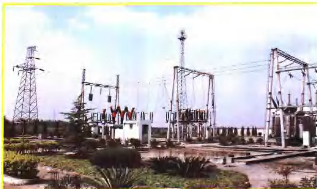
1995年7月投运的 110千伏新浦变电所
