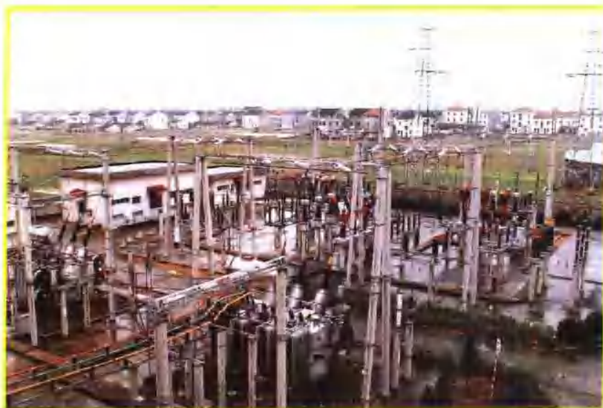
1993年建成的110千伏长河变电所
