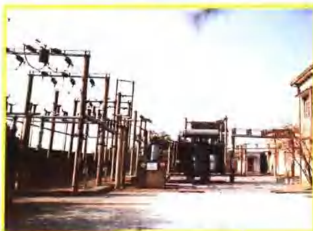
1982年建成的35千伏师桥变电所
