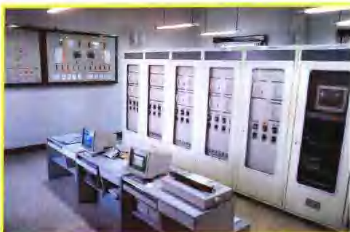
35千伏综合自动化匡堰变电所控制室
