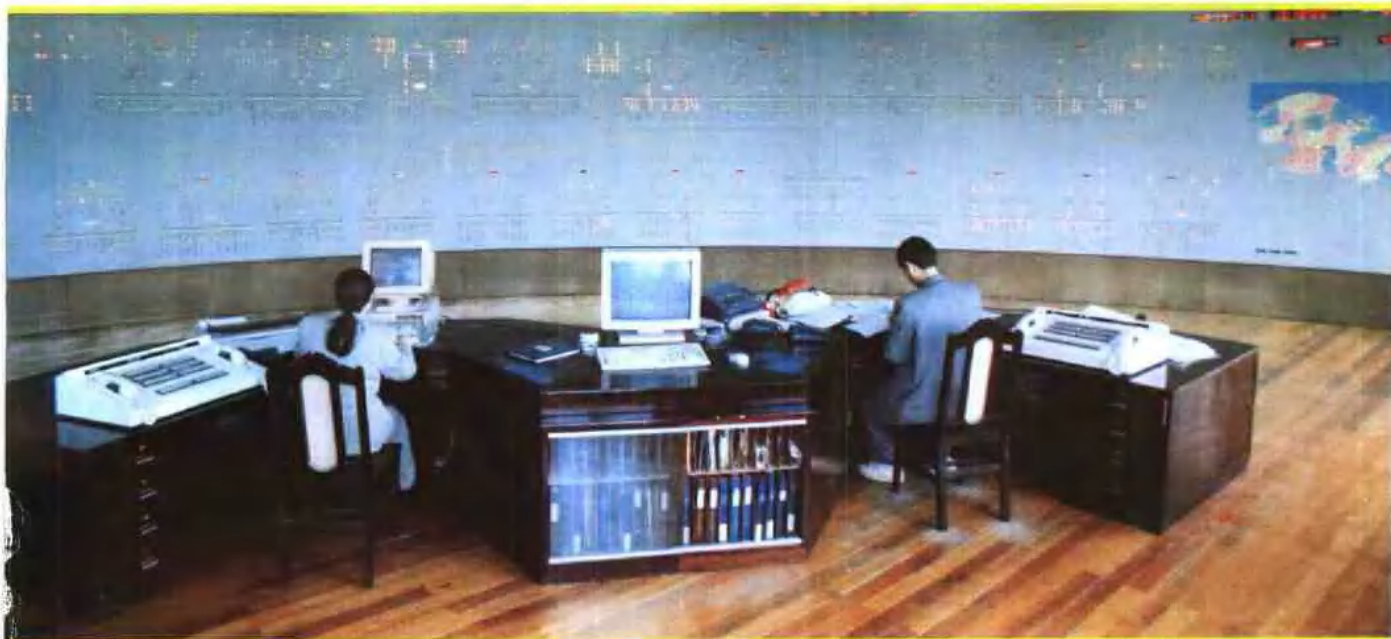
慈溪市供电局电力调度室
