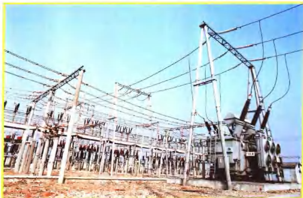
1995 年投运的 220 千伏慈溪变电所
