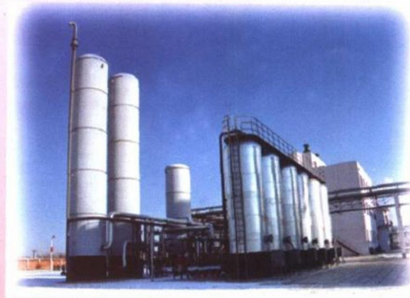
大庆油田化工总厂变压吸附提纯 \text{H}_2 装置
