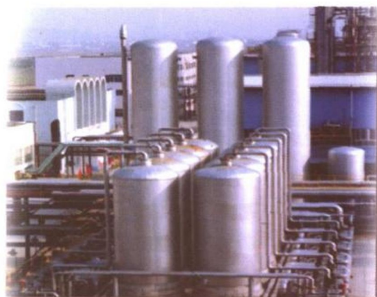
镇海炼化化工股份有限公司 6 万 \text{Nm}^3/\text{h} 变压吸附提纯氢气装置
