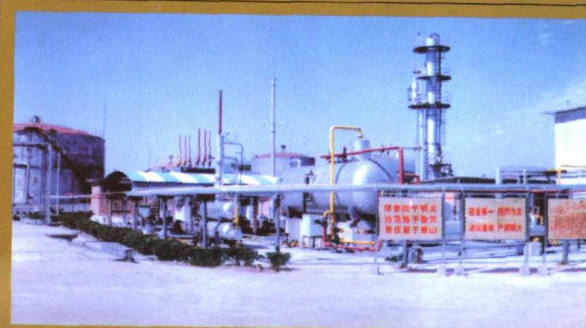
总公司“三标”站——富一站
