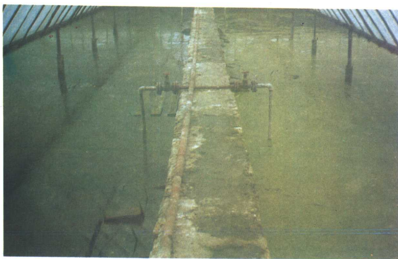
图 16 温棚输热管道
