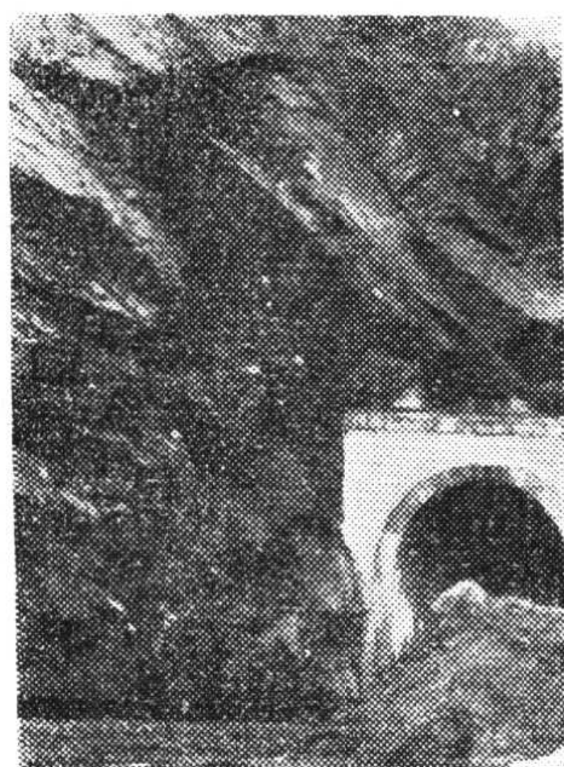
照 3-3 宋召溝三号隧道 南口路堑“断脚节理”
