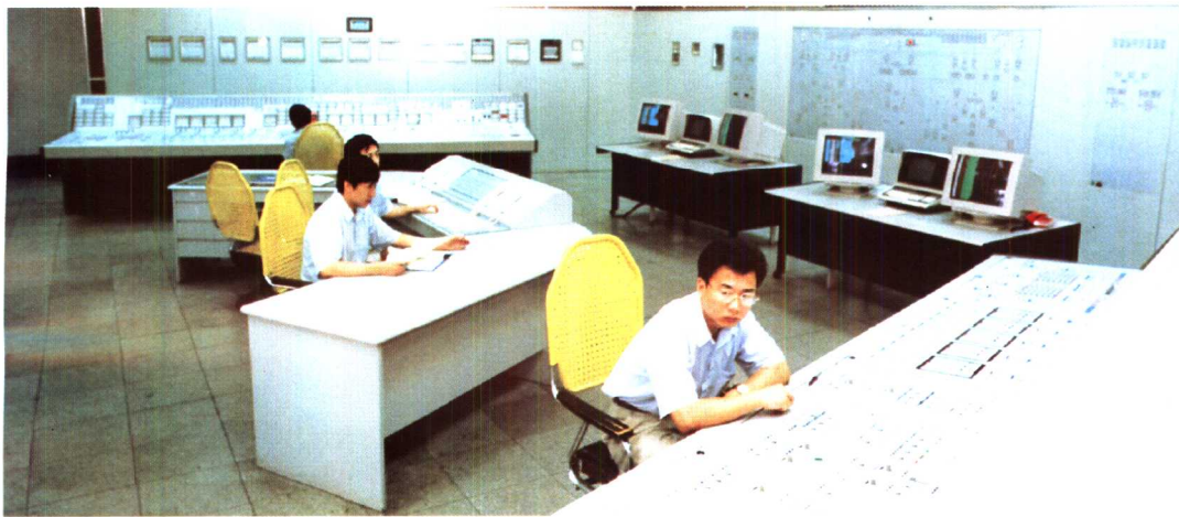
3、4 号机组控制室
