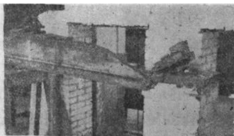
图 12 E 梁破坏情形
