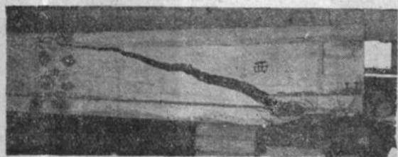
图 11 A 梁剪切破坏情形
