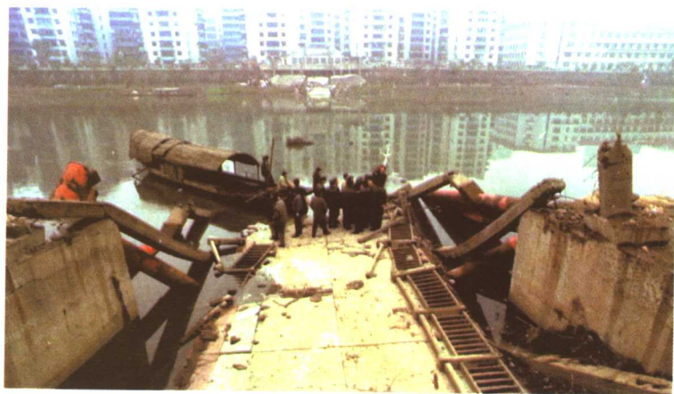
图31 垮塌后的虹桥
