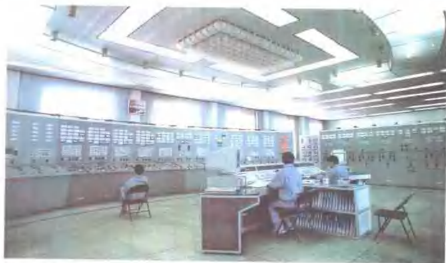
玛纳斯电厂主控室
