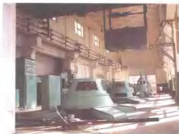
和田地区排筏瓦提水电站(装机 0.952 万千瓦)
