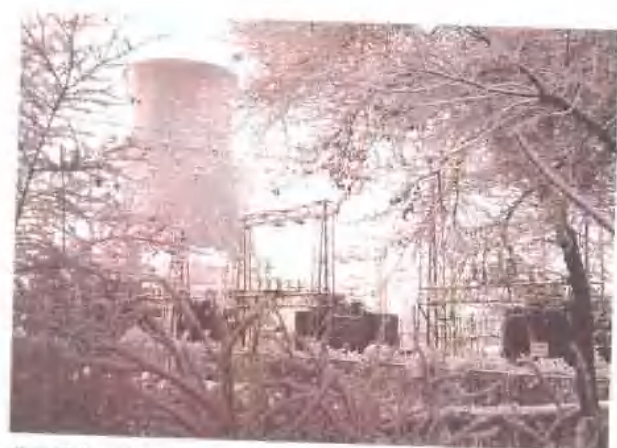
荆湖梁电厂升压站
