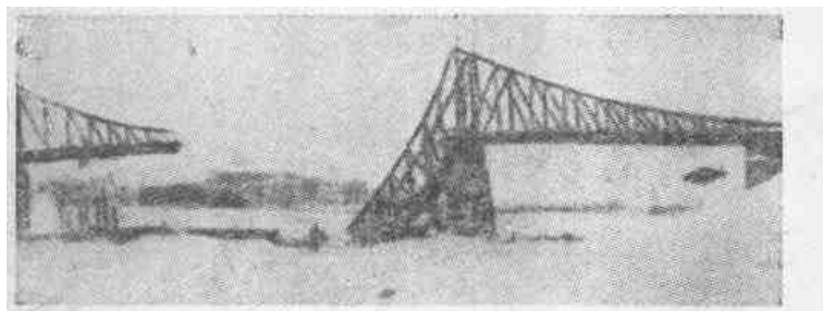
圖 7 梁式懸臂橋孔鋼結構的破壞
