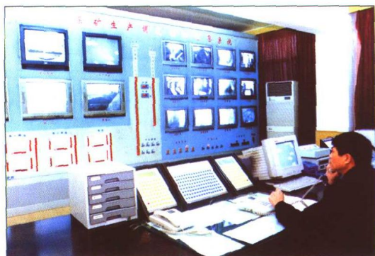
张双楼矿现代化生产调度室
