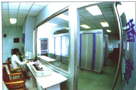
集团公司建立了以光缆传输为手段的现代化通讯网络。电话总量 3.4 万门，其中程控用户 2.7 万门。图为程控电话总机房
