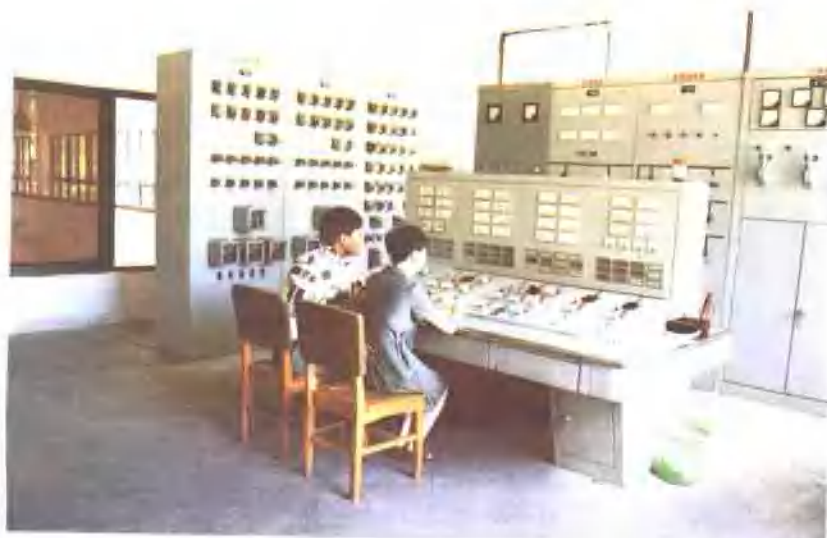
水电站中央控制室
