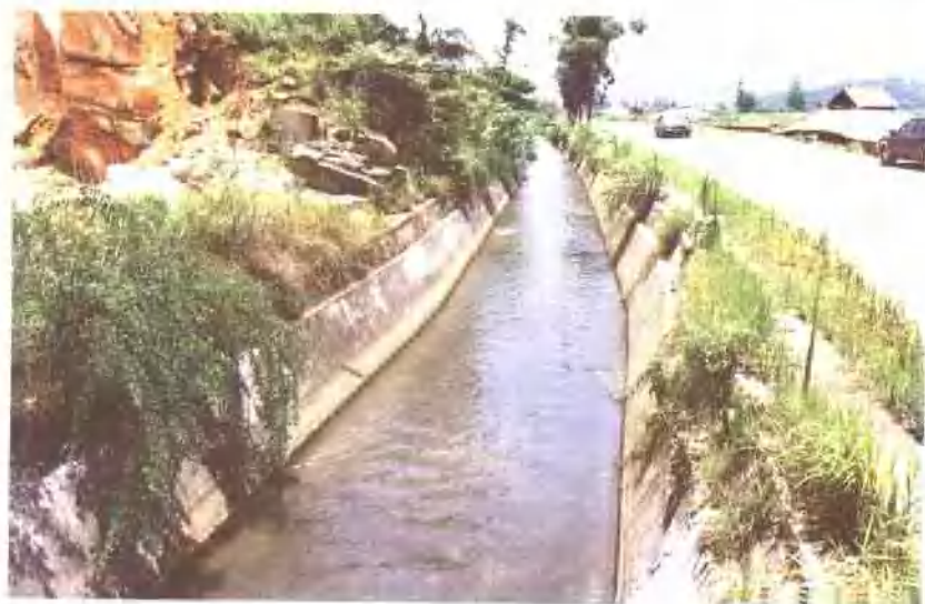
陶溪引水渠道
