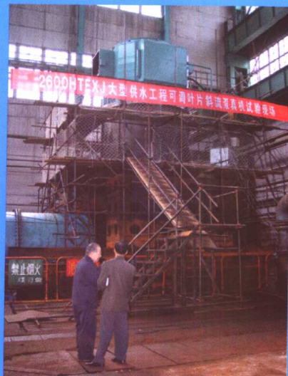
2600HTEXJ大型供水工程可调叶片斜流泵真机试验现场
