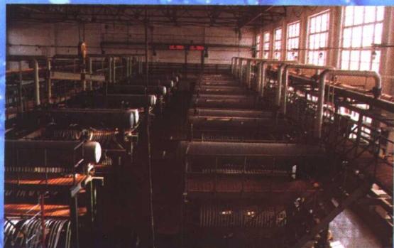
5万吨/年离子膜烧碱装置
