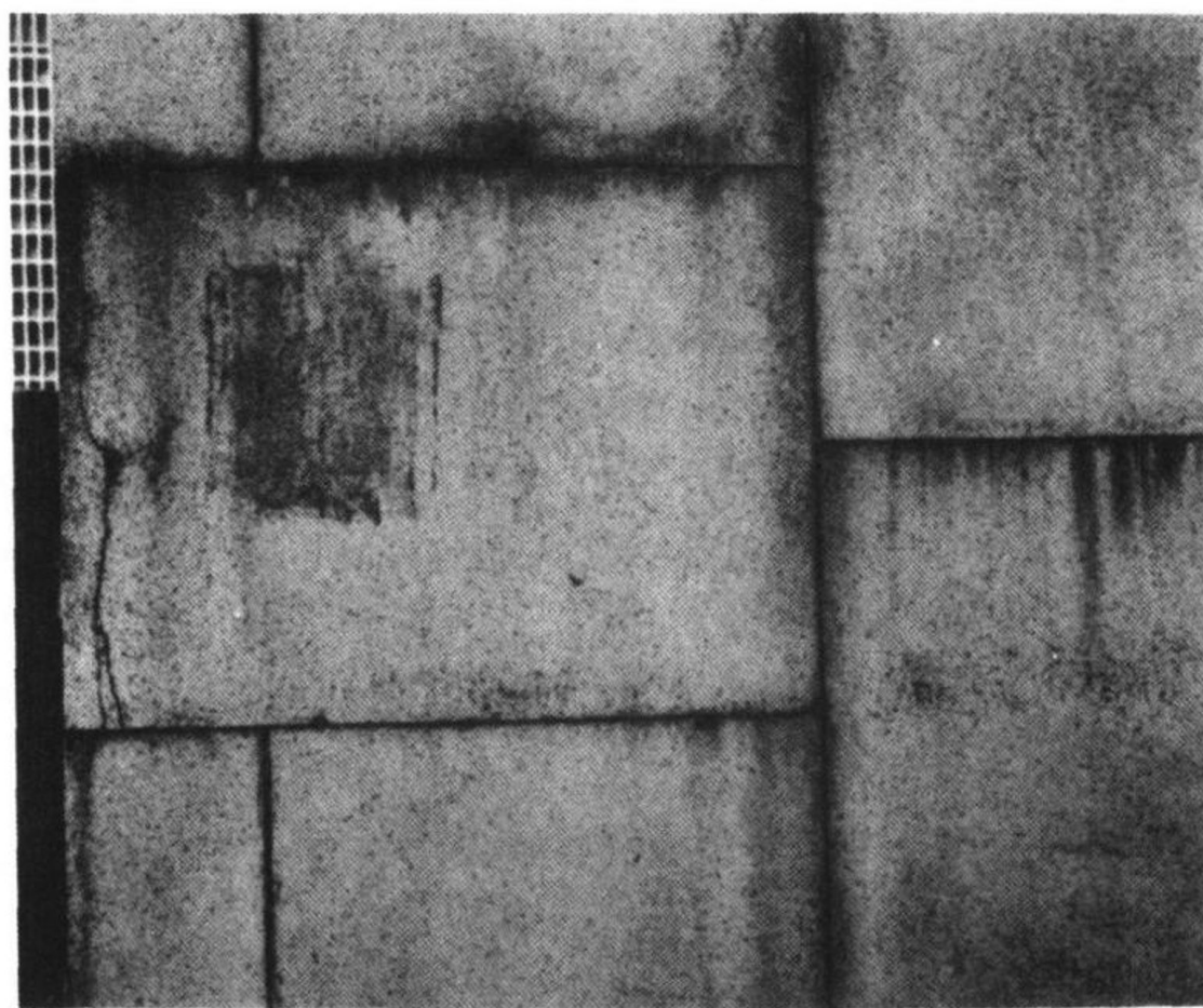
1 貼石之外牆的污染、裂縫、剝離之例
