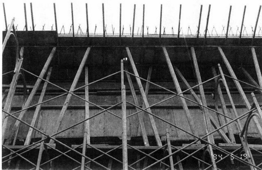
相片六 角材錯誤施工方式
