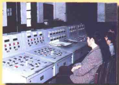
机械化装卸系统电器主控室
