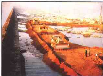
大廣壩水電站供電工程
