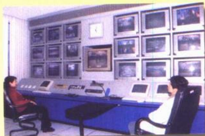
电视监控中心
