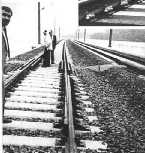
↑ ㉓ 德国的桥上无缝线路用伸缩接头
